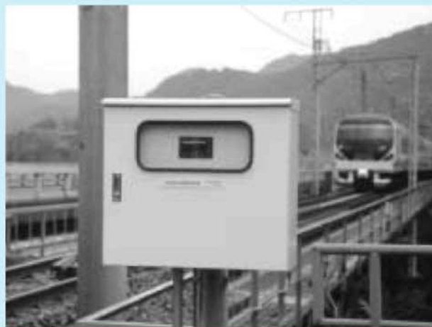
Пульт управления датчиками уклона мостовой опоры
